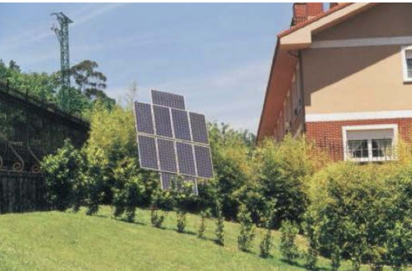
Instalación fotovoltaica en la sede del Patronato de la Reserva de la Biosfera de Urdaibai. Imagen: Reserva de la Biosfera de Urdaibai.
